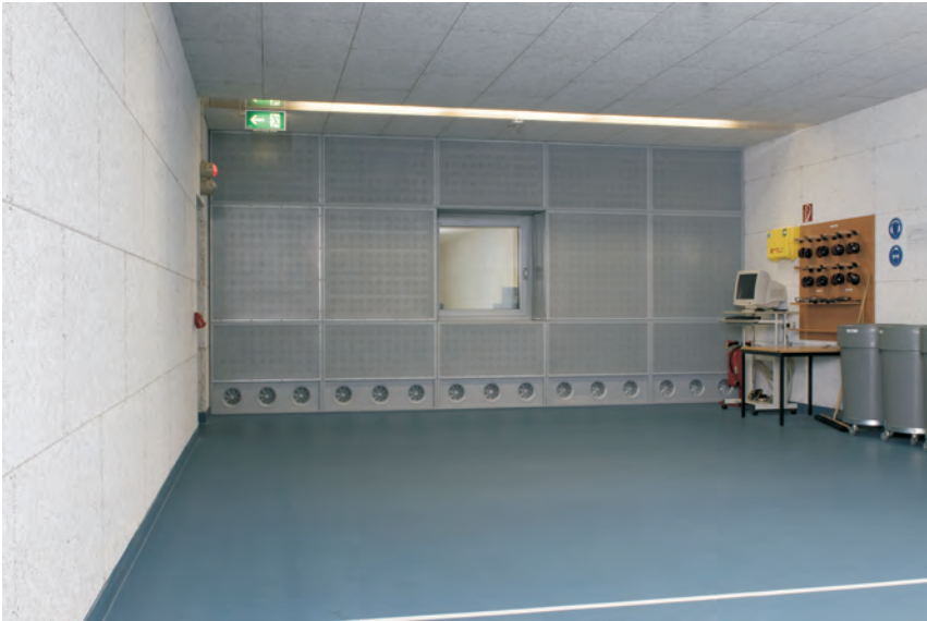
Abb. 4 RSA der Polizei Düsseldorf mit Fenster zum Regieraum in der Zuluftwand
