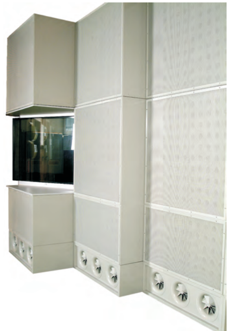
Abb. 7 RSA des Bundesgrenzschutz Bonn-Hangelar Die Module wurden versetzt angeordnet um eine schräg verlaufende Rückwand auszugleichen
